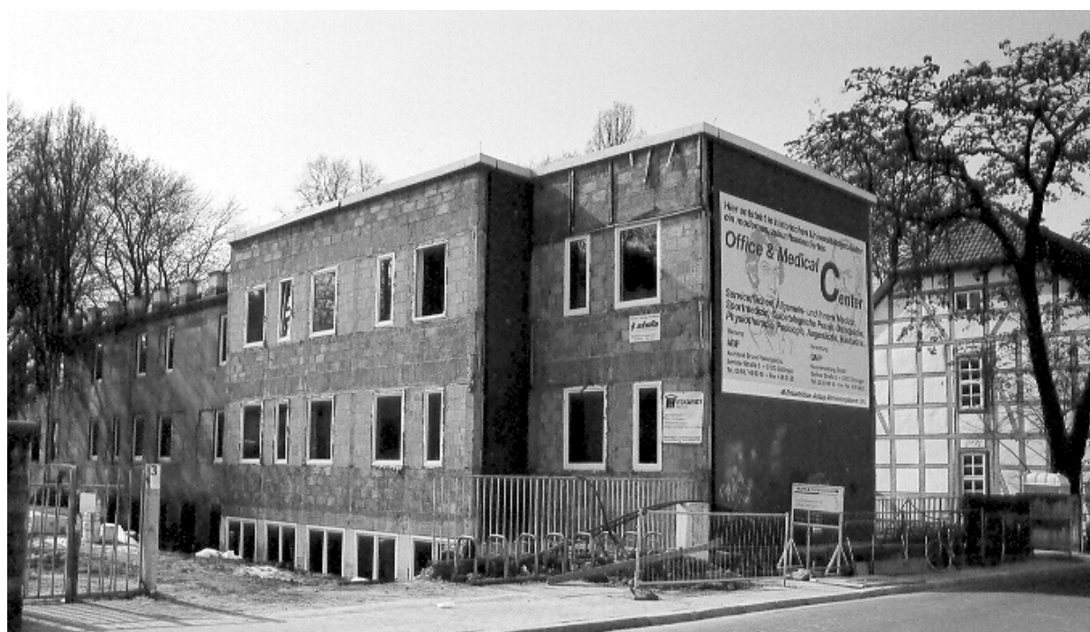
Abb. 1: Die Hospitalstrasse im Umbau. Die Liegenschaften der früheren „Biochemischen Abteilung“ für Windaus 1929 errichtet - mit dem vorderen Anbau der Metallphysik (Hospitalstraße 11), sowie das alte Fachwerkhaus – das Gmelin oder Wöhlerhaus von 1783 sind von der Niedersächsischen Liegenschaftsverwaltung verkauft worden. Es entsteht ein „Office & Medical Center. Das Plakat an der Fassade zeigt die Portraits von Wöhler und Wallach. Das Fachwerkhaus steht unter Denkmalschutz.
